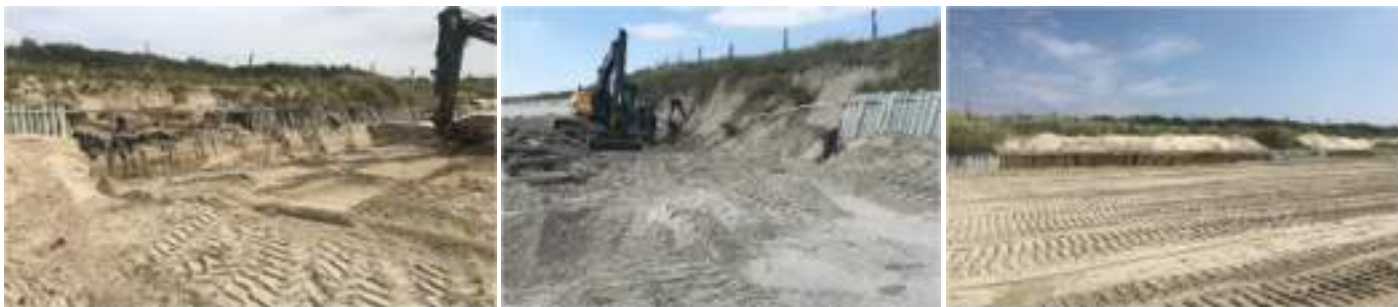
Figure 32 : Travaux de restauration pour changer les rondins de la digue de protection
