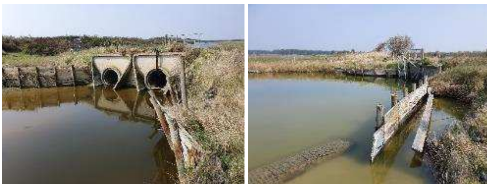
Figure 59 : Clapet et batardeau à la vanne mer
