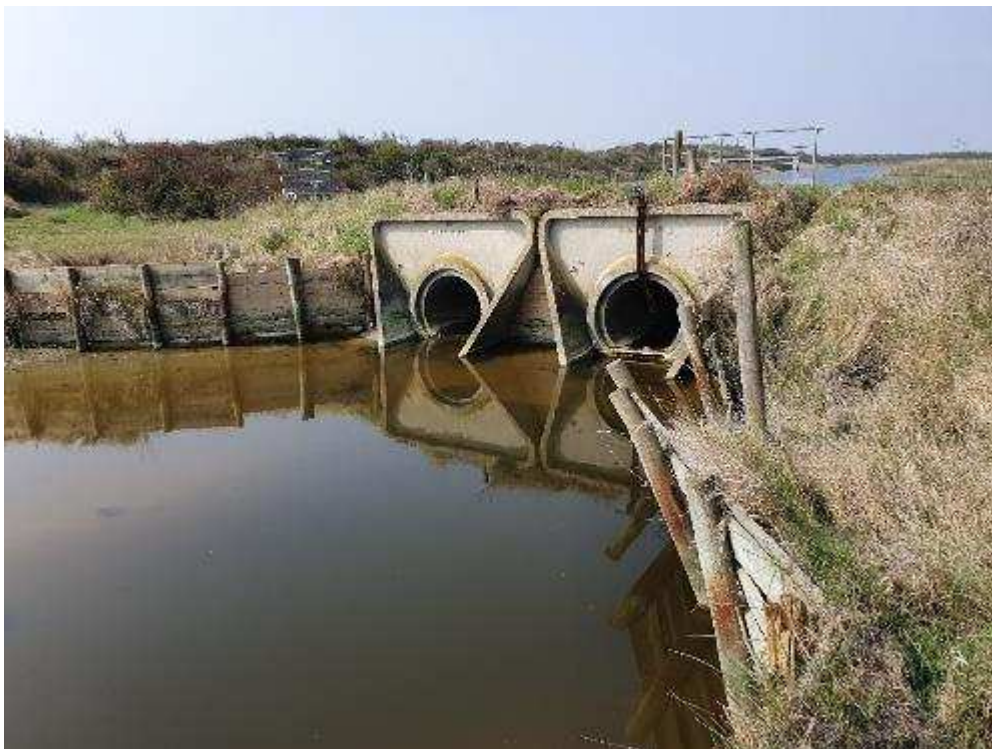
Figure 25 : Vanne de connexion à la mer
